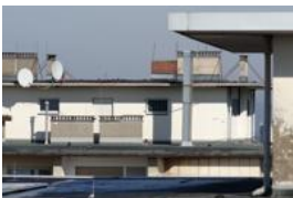
Le câble d'alimentation sur le toit
