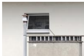
Le câble d'alimentation atteignant la prise
