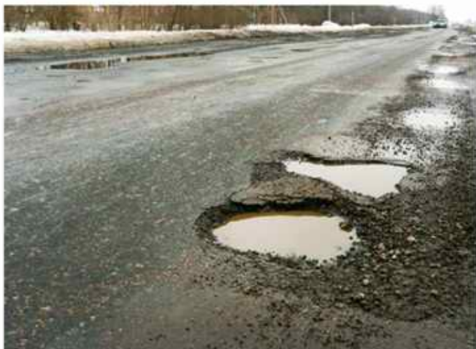
Wietrzeniu mrozowemu ulegają nie tylko skały. Skutkiem tego procesu są także dziury, które powstają w asfaltowych nawierzchniach dróg.
